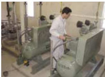
医療ガス機械室でのコンプレッサーの稼働状況
