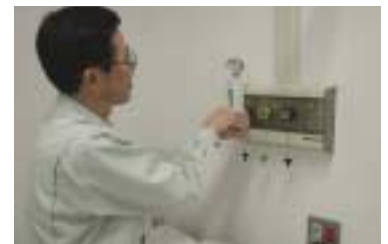
アウトレットテスターによる点検
